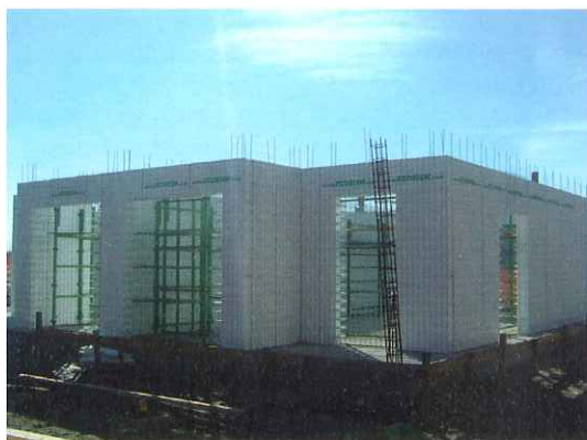
il sistema ECOSISM in cantiere: velocità ed efficienza al servizio delle imprese
